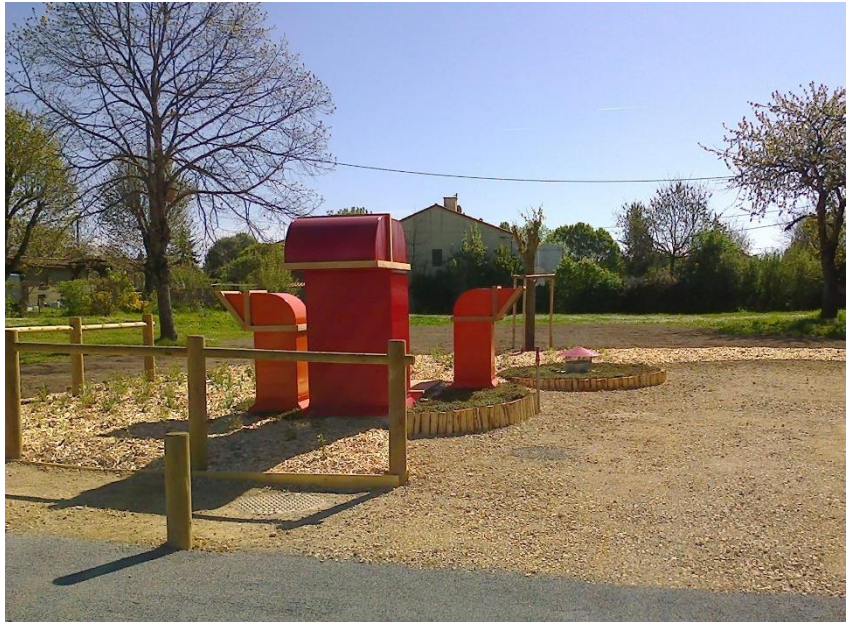
Figure 2 : poste Refoulement Amuré
