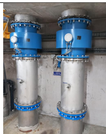
Fig. 4c : Renouvellement des débitmètres entrée station Goilard
